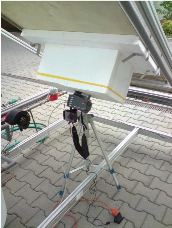
Rys.2. Termowizyjny pomiar temperatury elementów składowych kolektora
