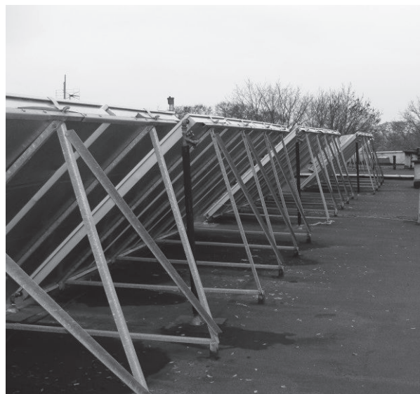
Rys. 2. Kolektory słoneczne zamontowane w D.P.S. w Nowej Wsi Elckiej
