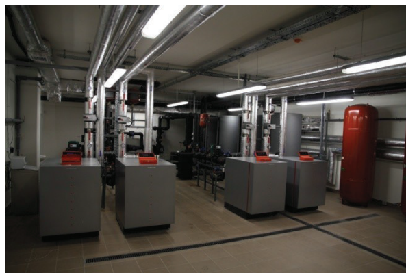
Rys. 3. Poziom -1 budynku – kaskada pomp ciepła odpowiadająca za ogrzewanie budynku.
