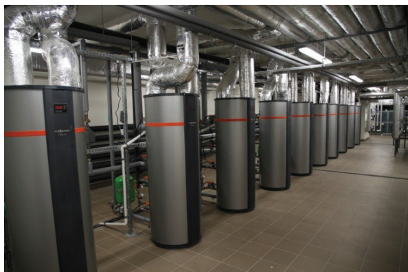
Rys. 1. Poziom -1 budynku - bateria pomp ciepła do przygotowania ciepłej wody użytkowej.
